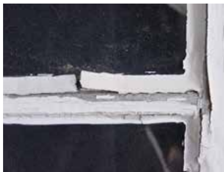
Fenster mit brüchiger Kittfuge
