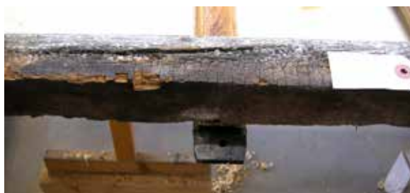
Konstruktive Schäden am Holz: Würfelbruch
