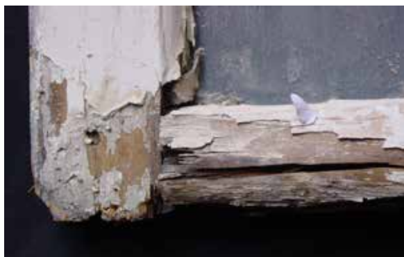
Abblätternde Farbfassung an den Fenstern im Vorzustand
