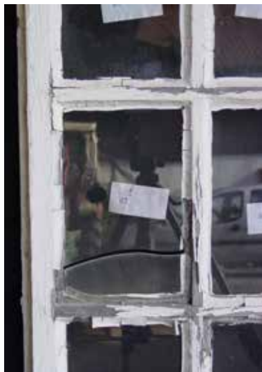
Fenster vor der Restaurierung: Viele Scheiben waren zerbrochen.
