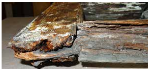
Konstruktive Schäden am Holz: Holzfäule
