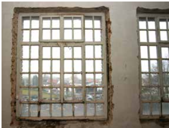
Fenster im 2. Obergeschoss vor der Restaurierung mit deutlich erkennbaren Schäden und Verschmutzungen
