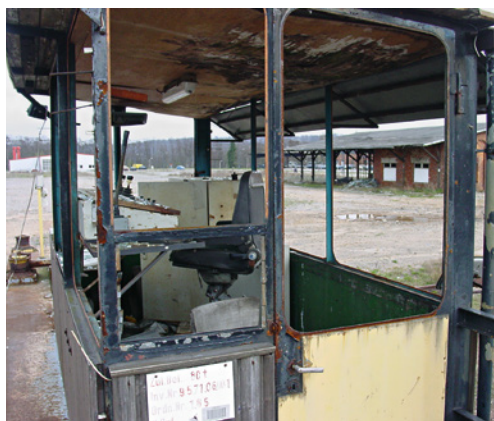
2 Im Führerhaus fehlen Glasscheiben, Müll liegt auf dem Boden, 2005
